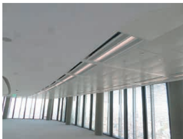
Esempio di integrazione degli impianti al piano con l'illuminazione naturale e con quella artificiale
