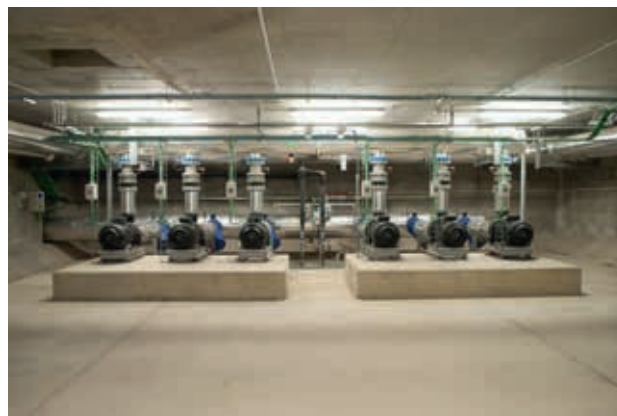
Centrale termofrigorifera ai piani interrati
